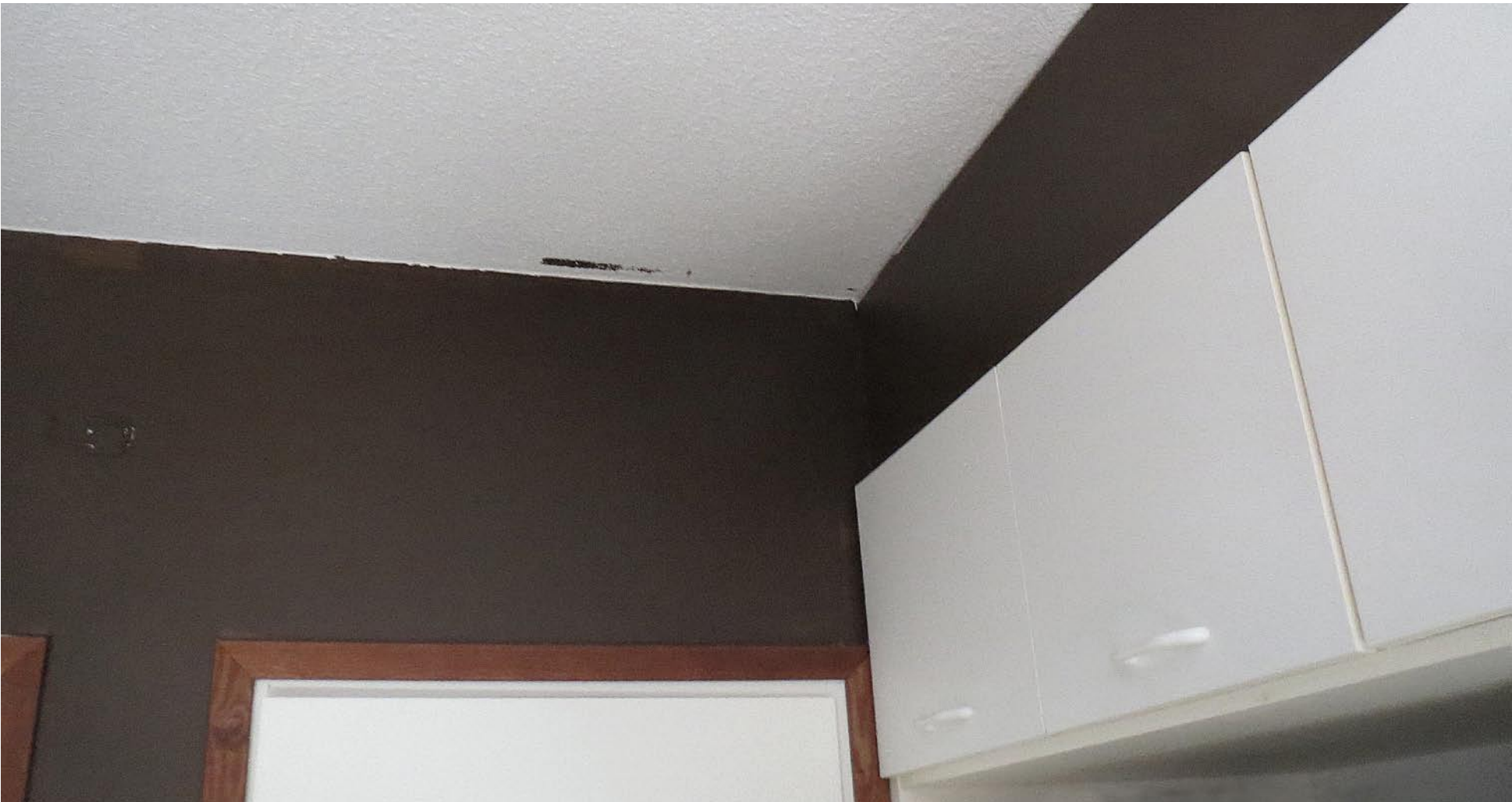
Kuvassa on esimerkki maalauksesta, jonka asukas joutuu korjaamaan. Tumma väri on palautettava alkuperäiseen vaaleaan ja katon tahrat korjattava, eli käytännössä katto on maalattava uudestaan.
