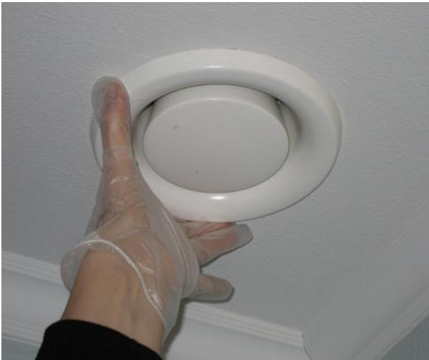
4. Keskikappaletta eli säätöosaa ei saa säätää itse. Keskikappale on lukittu kanavatarkastuksessa ja säädetty niin, että oikeat ilma-määrät poistuvat asunnosta.
